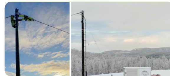
Provisorisk høyspentstasjon til NATO-øvelser på Camp Akkasæter
